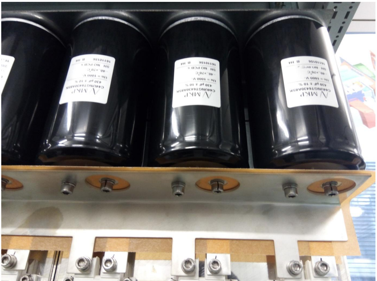
Irudia 116. DC buseko kondentsadoreak eta busbarra.
