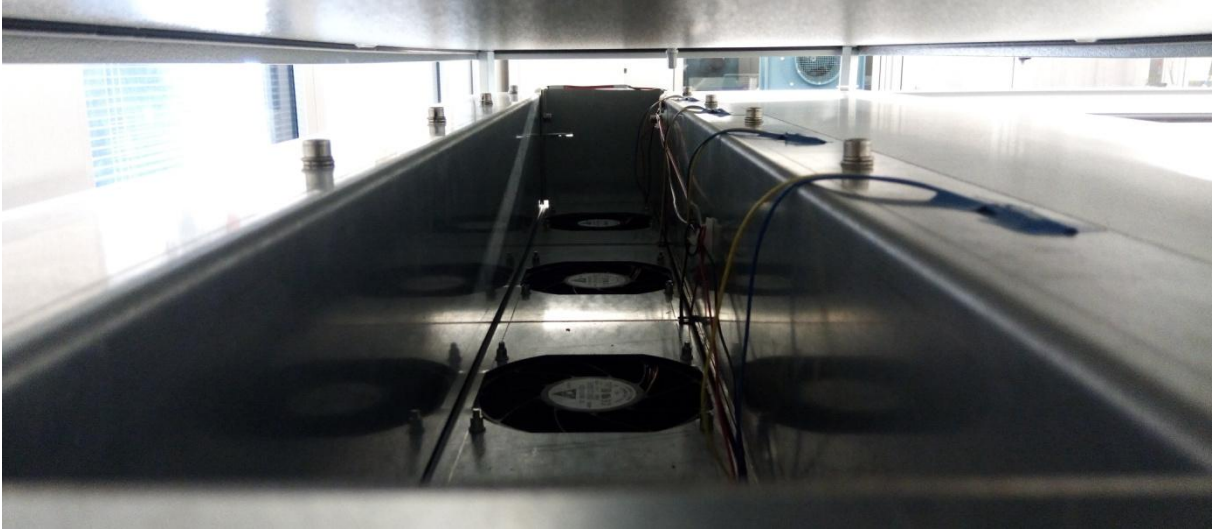
Irudia 117. Bentilazio kanala haizagailuekin.
