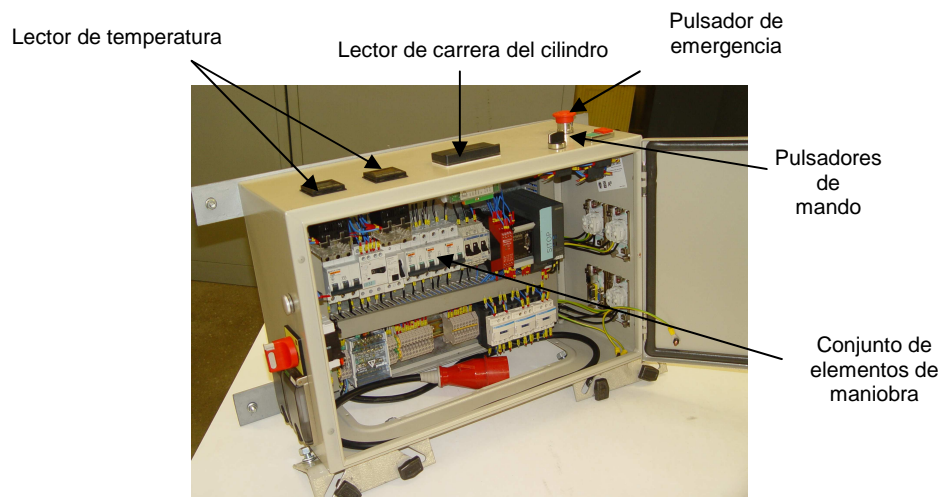
Figura 5.15.- Cuadro de maniobra de la Instalacion Termogravitacional.
